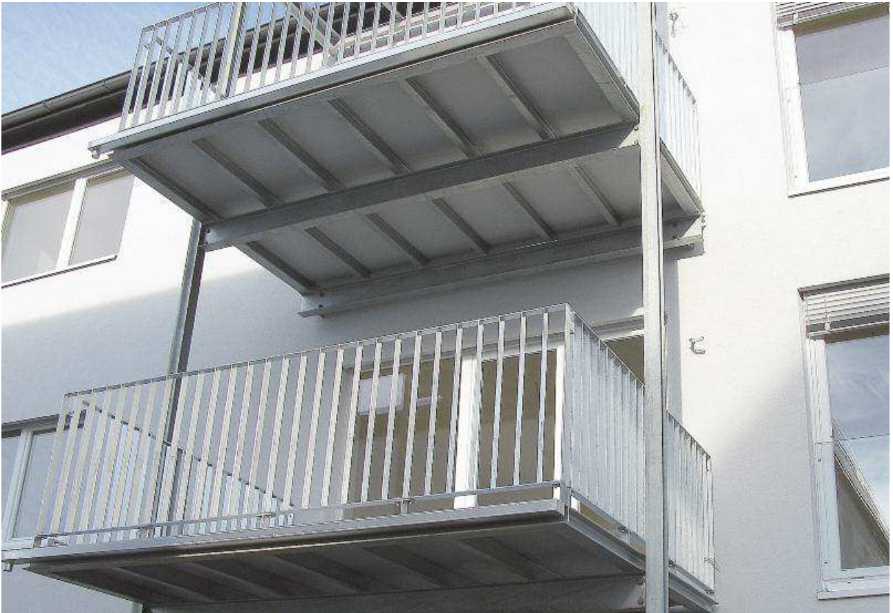
Balkonbodenplatte Objekt St. Veit/Glan, Österreich
